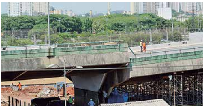
Viaduto na Marginal Pinheiros, em São Paulo, que cedeu em novembro de 2018, será um dos objetos de discussão.
