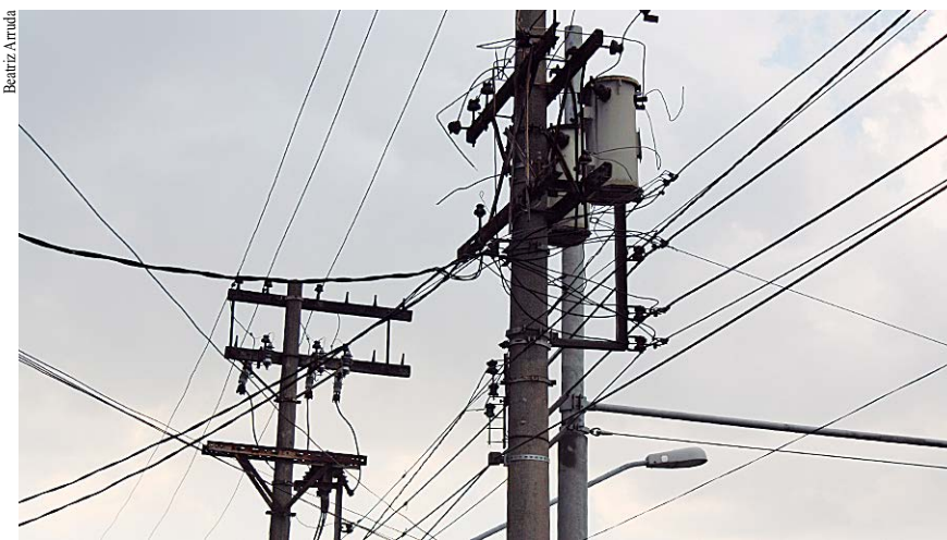
Sem cumprimento de normas técnicas, emaranhado de cabos e fios é comum nas cidades brasileiras, colocando em risco população.
