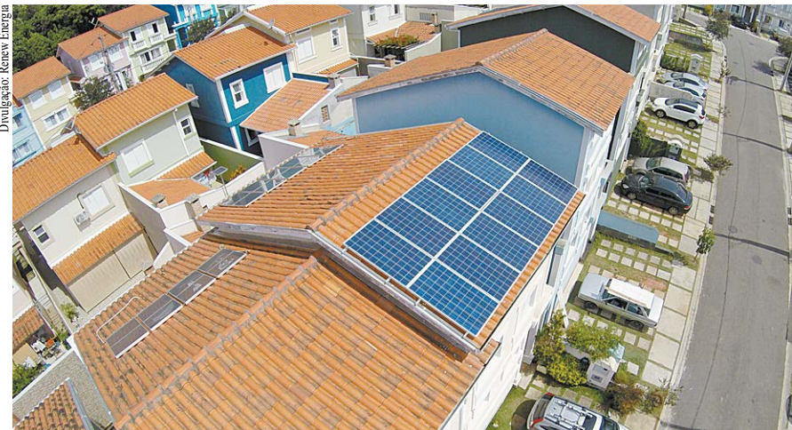
Imagem aérea do sistema instalado no telhado de casa em Jundiaí (SP) pela Renew Energia.
