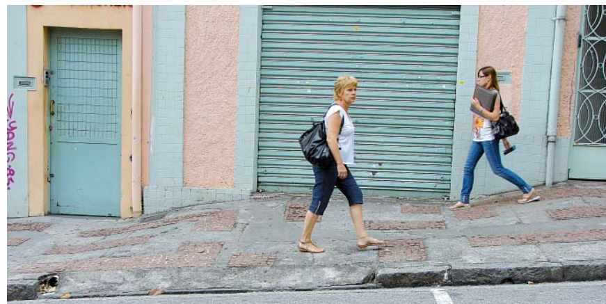
Calçada da Rua Major Sertório é exemplo de desnível e pisos inadequados.
