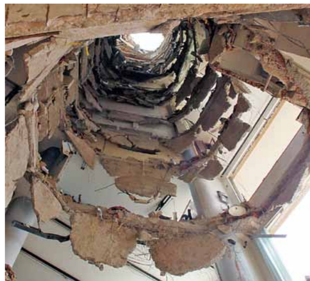
Queda de prédio em São Bernardo do Campo aponta para necessidade de conservação das edificações e de assistência por parte de engenheiros em caso de reforma.
